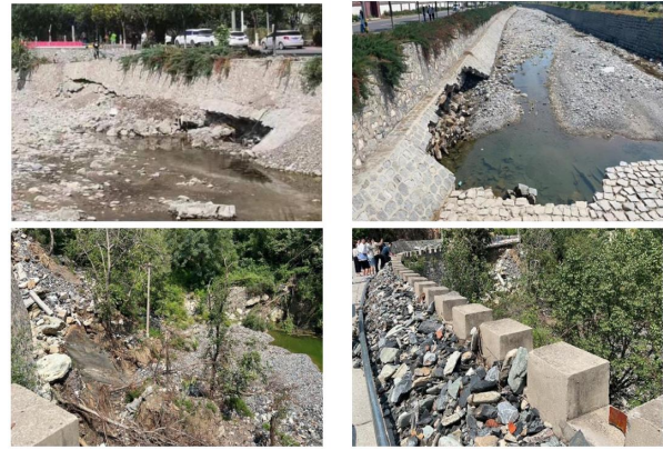
部分道路挡墙基础掏空、山体滑坡导致道路堵塞
